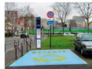
Photo 10 : Stationnement réservé borne électrique
